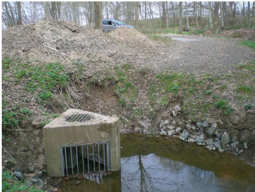
Bild 3.10. Mindre damm vid nedre änden av en ravin med inloppet till den kulvertledning, som nedströms leds under IKEA-området. I bakgrunden ses högar med jord som troligen har rensats ut ur dammen med en grävmaskin. Delområde B:501. Foto: SGI.
