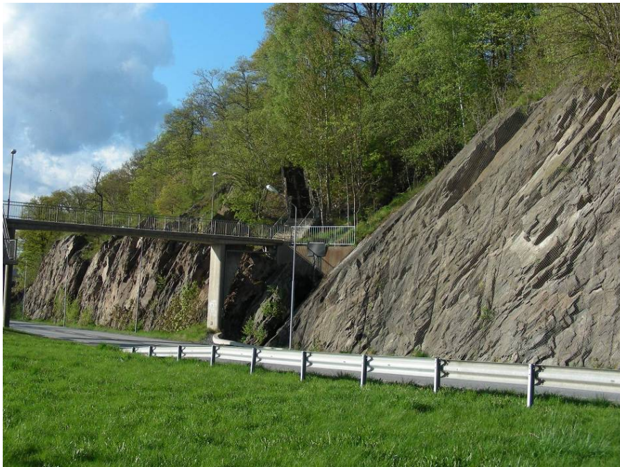
Bild 3.15. Bergskärning längs Ådalsvägen söder om Egna Hem (1 km söder om B:601 och B:602). Notera att när förskiffringsplanen når den fria släntytan kan släntstabiliteten försämrats om bergschaktning genomförs vid släntfot. Foto: SGU.
