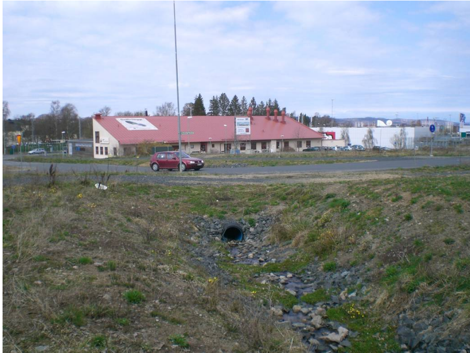
Bild 3.11. Vattnet från raviner och ett avskärande dike leds via en kulvert, ca \phi 500 mm, under en väg. Delområde O:505. Foto: SGI.
