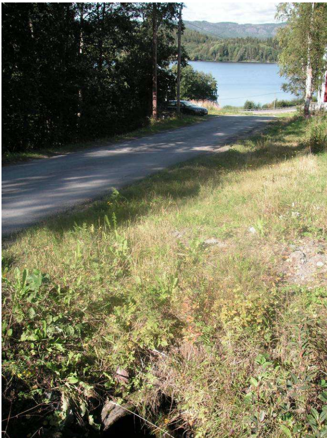
Bild 2. Nedströms vägtrumman har bäcken bildat en ca 5 m djup ravin vid vägens vänstra (södra) sida. Ravinen leder ner mot bebyggelse.
