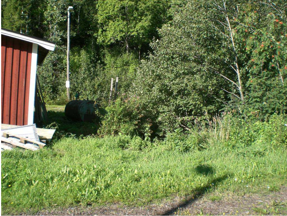
Bild 13. Kulvertinlopp. Ris och bråte är slängt i kulvertinloppet. Härifrån är bäcken sedan kulverterad längs en ca 70 m lång sträcka
