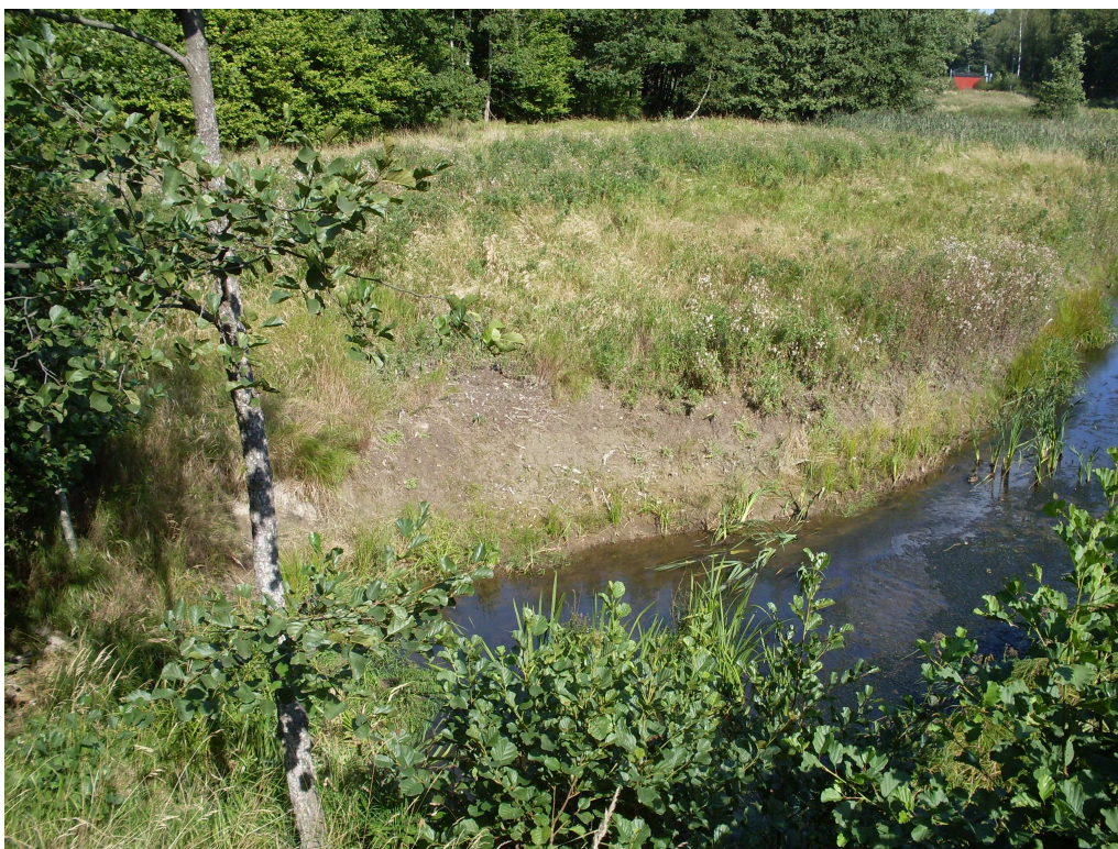
Figur 7-2. Slänterosion i ett mindre vattendrag vid Nynäs gods i de västra delarna av Nynäs- hamns kommun. Foto: SGI
