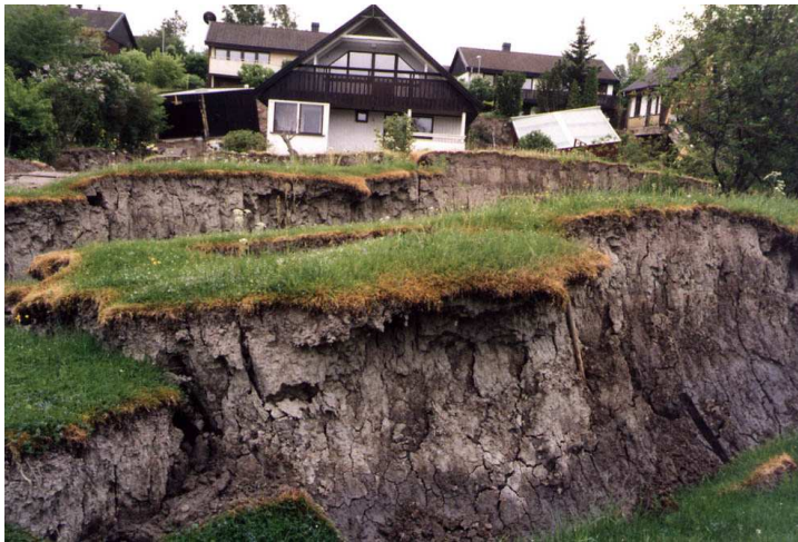
Figur 9-7. Skred i Vagnhärad 1997. Foto: SGI.
