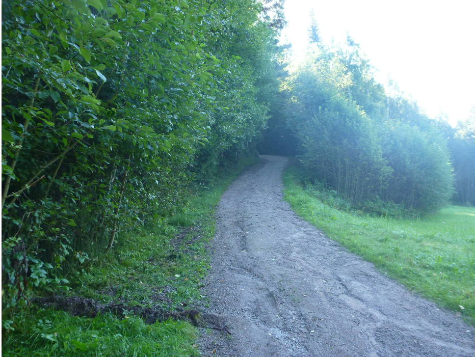
Karteringspunkt nr 4. Vy över släntfot. Spår av erosion i vägen.
