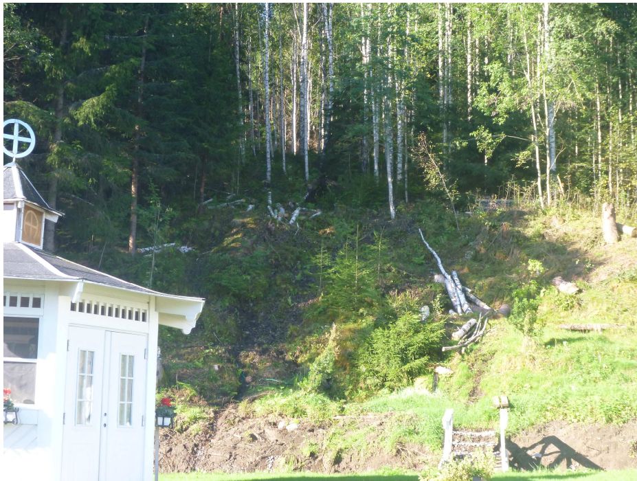
Karteringspunkt nr 1. Avverkning i slänt ner mot bebyggelsen. Glacial silt-och sand i slänterna. Jordflytning förekommer vid intensiva regn enl. uppgift från bofast.
