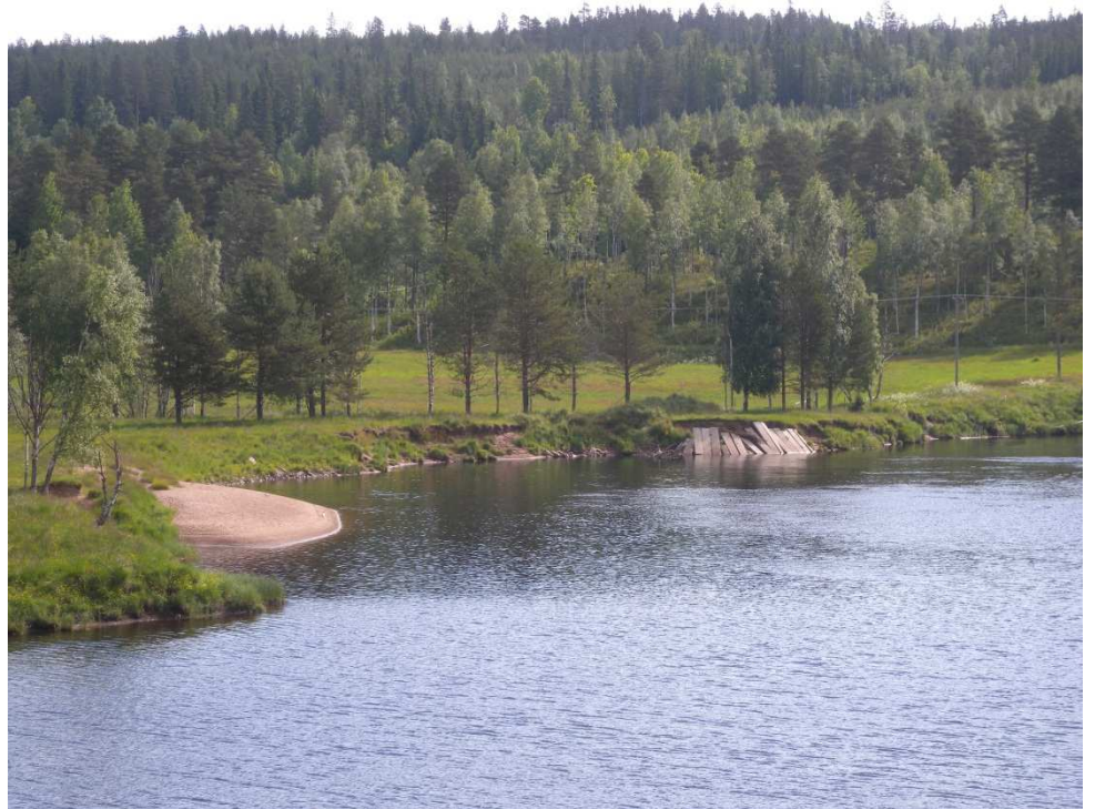
Erosion och erosionsskydd utmed Västerdalälven vid Sörnäs i Lima, Malung-Sälens kommun. Foto: SGI
